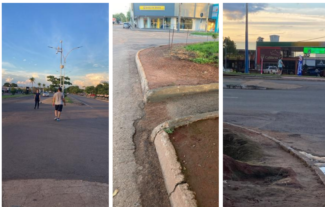
Figura 2.16: Obstrução da calçada.
