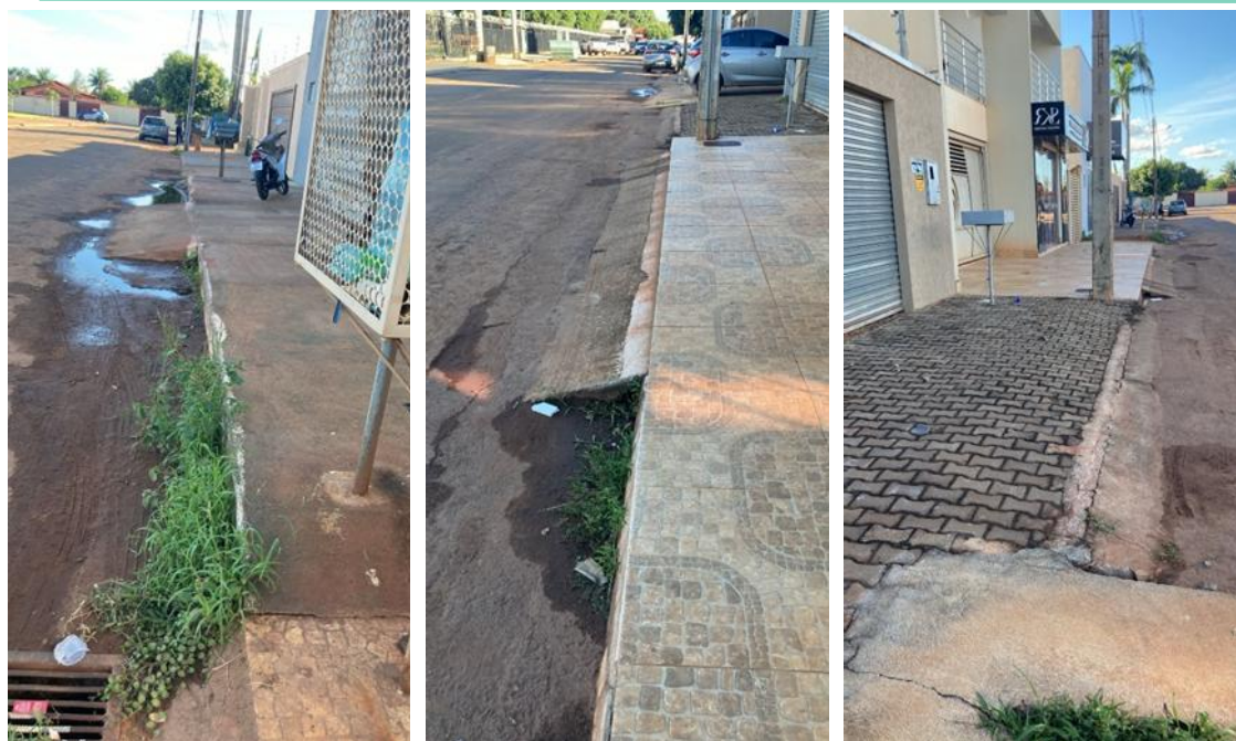
Figura 2.13: Obstrução da sarjeta.
